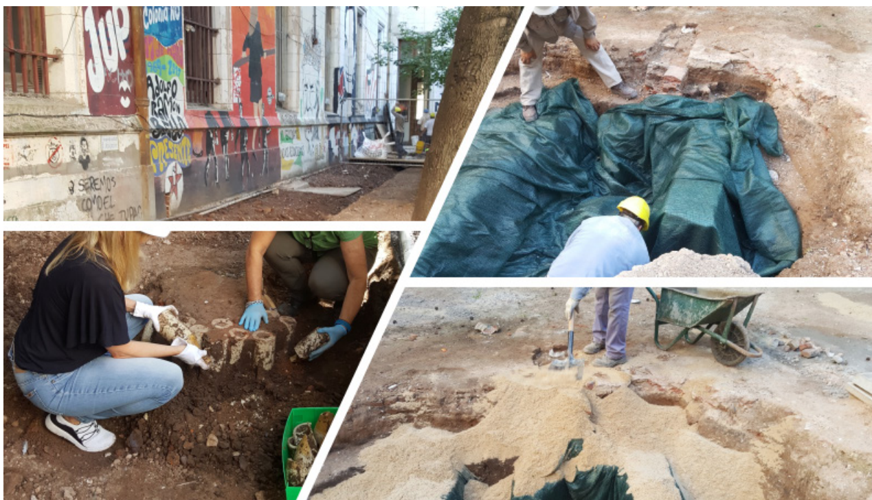
Figura 12. Retiro de botellas de gres que conformaban el contrapiso. Relleno y recubrimiento con el geotextil del sector bóveda, 2019.
